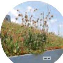
Centre suisse de Pflanzbau: une application moderne du toit à 800 mètres au-dessus du sol, un mélange de beaux végétaux indigènes sur le toit isolé assure une isolation et un rafraîchissement.
